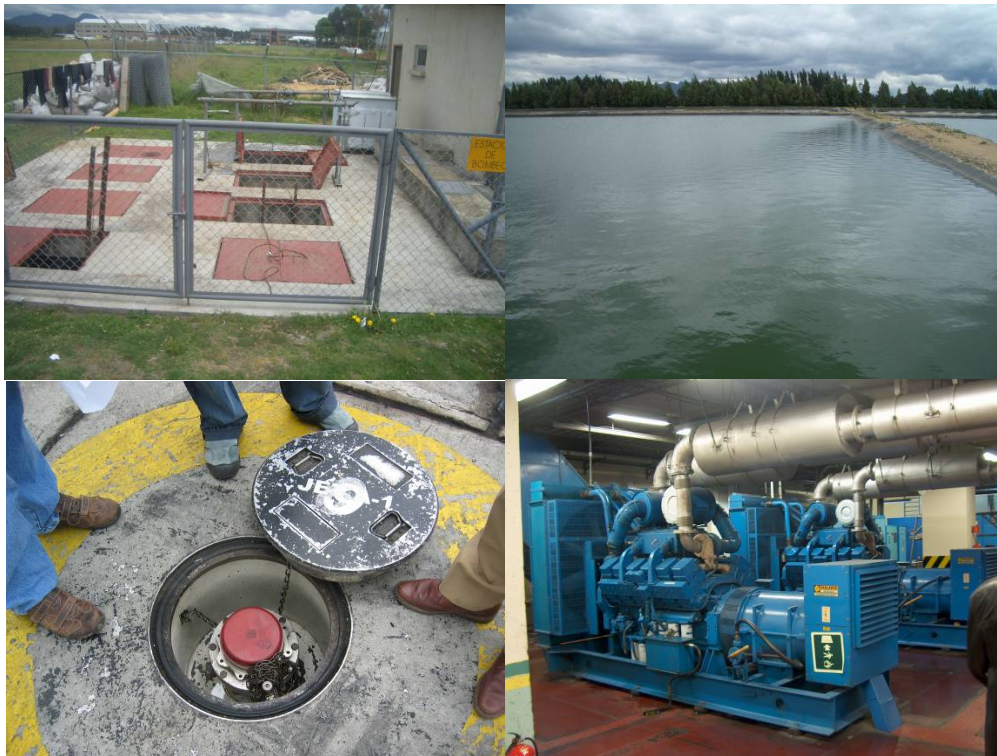
Abwasserpumpwerk (o l), fakultative Teichkläranlage (o r), Taki (u l), Ersatznetz-dieselmotor (u r)
